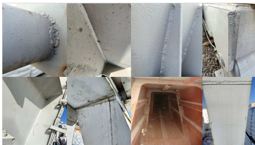
Рис. 4. Поверхности основного металла и сварные швы крана где проводилась цветная дефектоскопия
