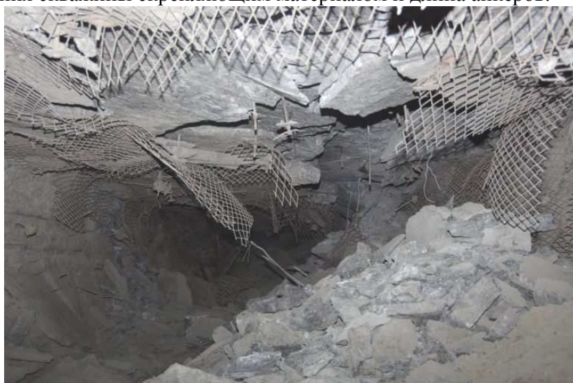
Рис. 1. Обрушение пород кровли в доставочном штреке
