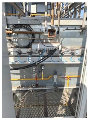
Рис. 2. Рукавный фильтр Аспекс и ресивер системы регенерации, оснащенный системой организованного сбора «свободного» азота в камеру чистого газа на промплощадке ПАО «НЛМК»
