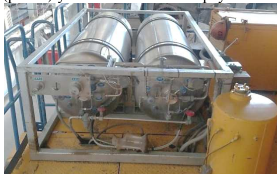
Рис. 4. Криогенные топливные баки, установленные на палубе газодизельного БелАЗ 75131
