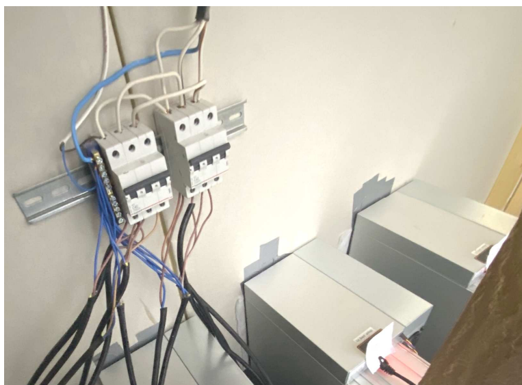
Рис. 5. Подключение системы к автоматам
