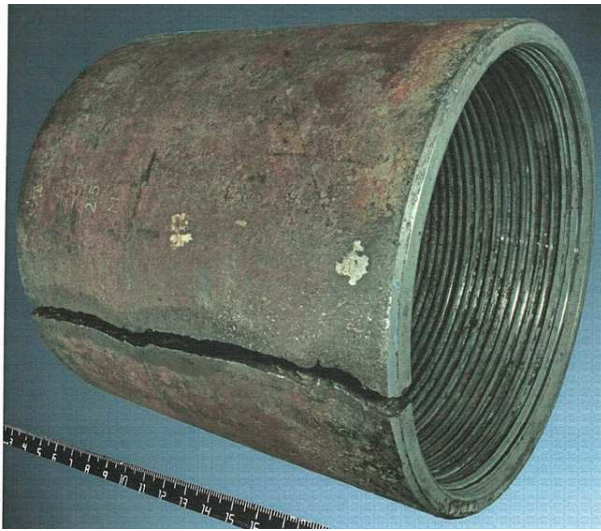
Рис. 1. Разрушенная муфта обсадной трубы \varnothing 168 \times 8,9 мм со сквозной продольной трещиной
