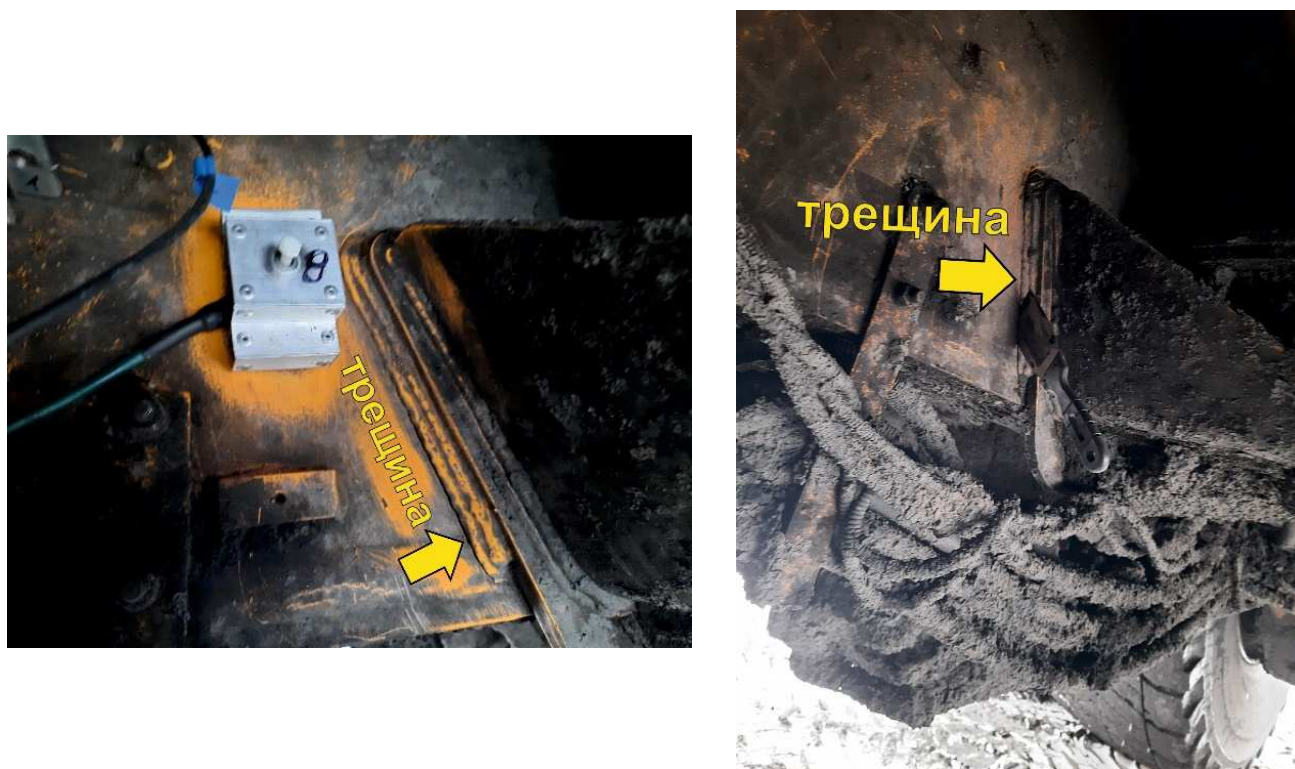
Рис. 2. Трещина в сварном шве рамы
