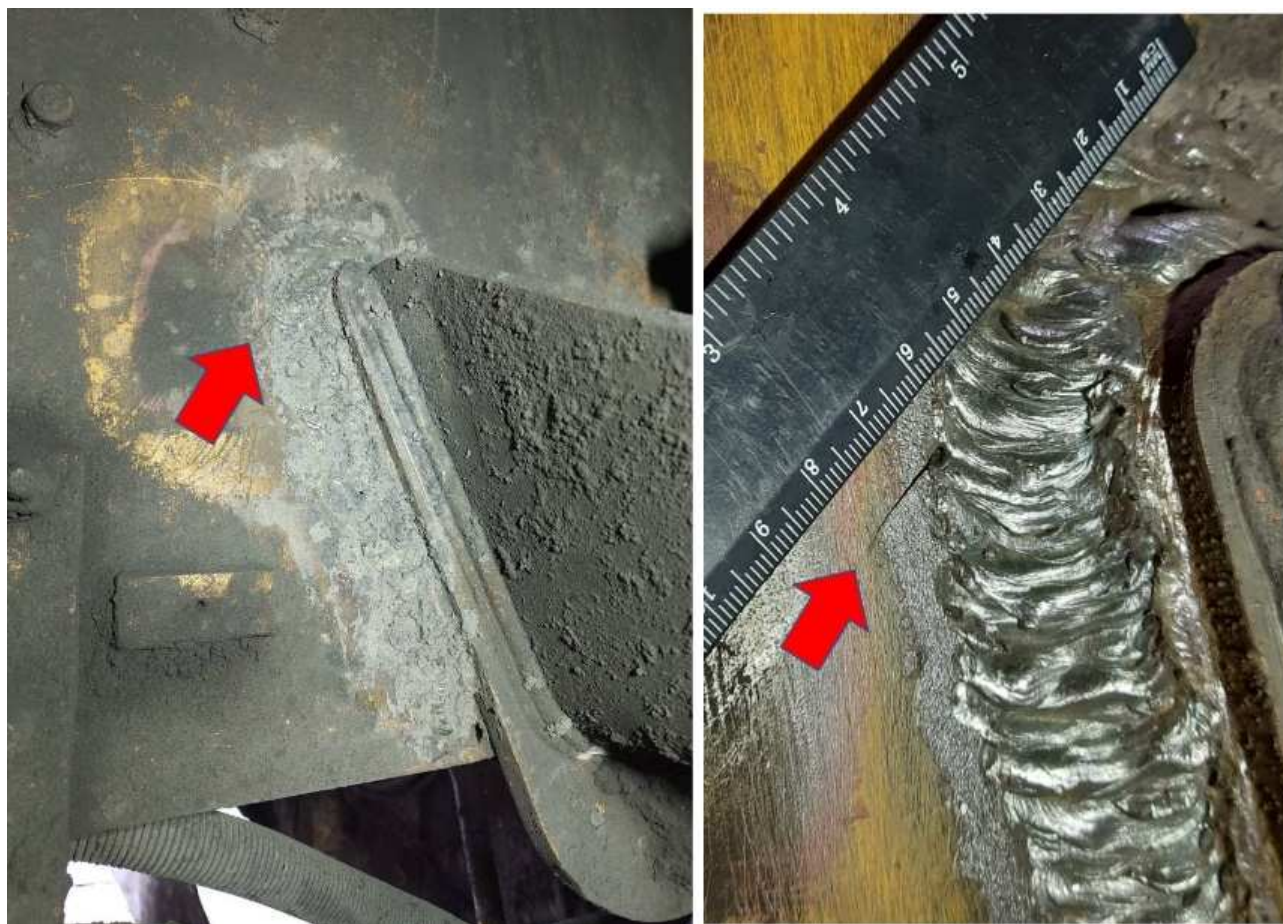
Рис. 4. Не заваренная трещина в раме
