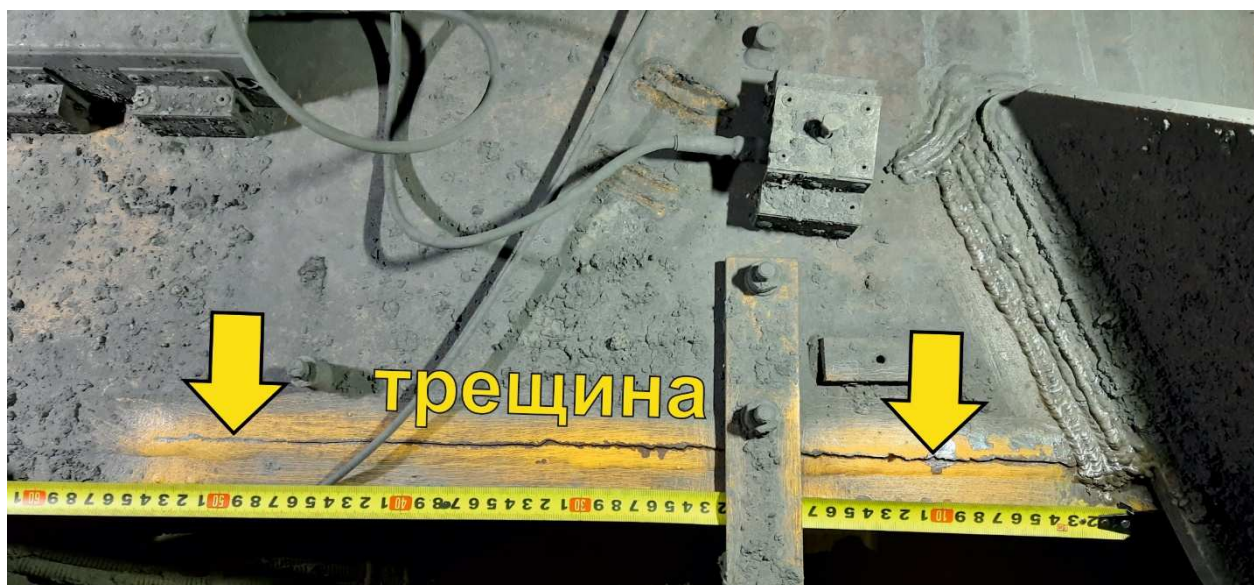
Рис. 6. Трещина в раме
