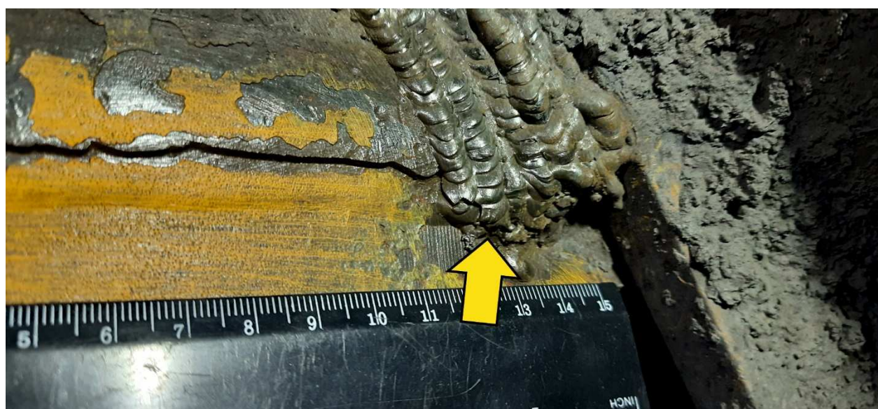
Рис. 7. Начало трещины в сварном шве приварки опоры двигателя
